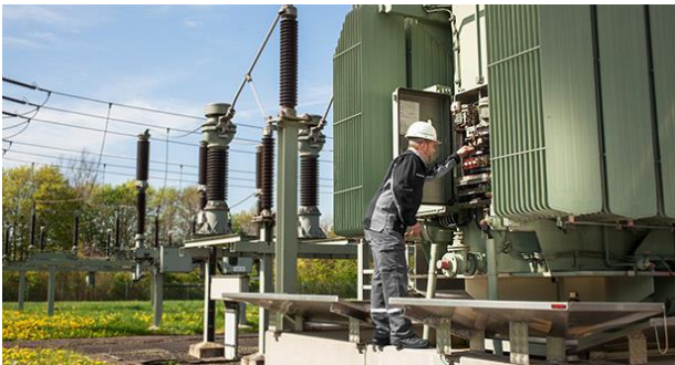
Umspannwerk der EnergieNetz Mitte GmbH
