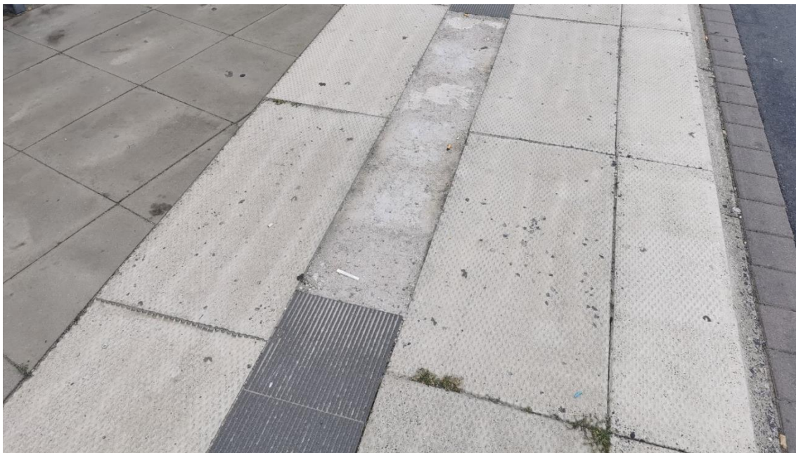
Abbildung 38: ZOB Worbis – beschädigte Bodenindikatoren
