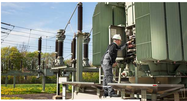
Umspannwerk der EnergieNetz Mitte GmbH
