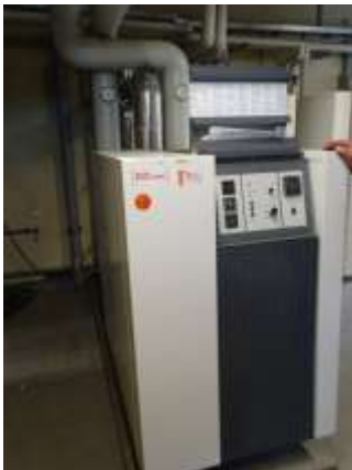
Abb. 40: Wärmeerzeuger Sporthalle Dingelstädt.
