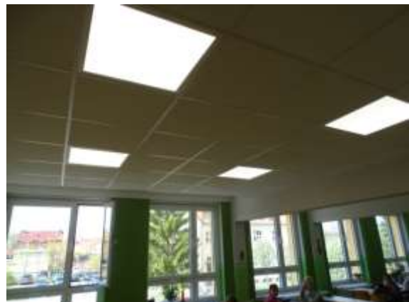
Abb. 60: Rasterleuchte als LED-Panel
