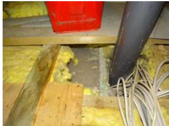
Abb. 56: Dämmungslücken durch Installation von Leitungen.
