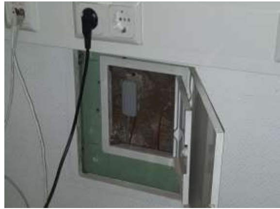
Abb. 73: Wärme- und Feuchtefühler Wandheizung.
