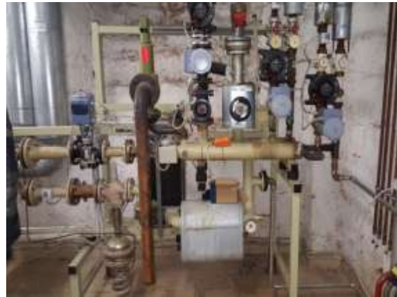
Abb. 88: Fehlende Dämmung der Übergabestation.
