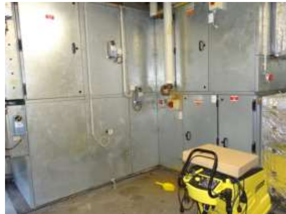
Abb. 41: Lüftungsanlage Sporthalle Dingelstädt.
